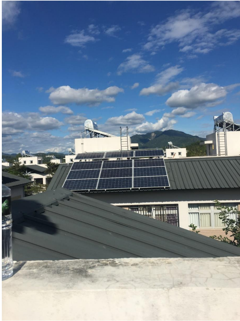
圖 2 3kW_p 住宅屋頂設置之外觀
